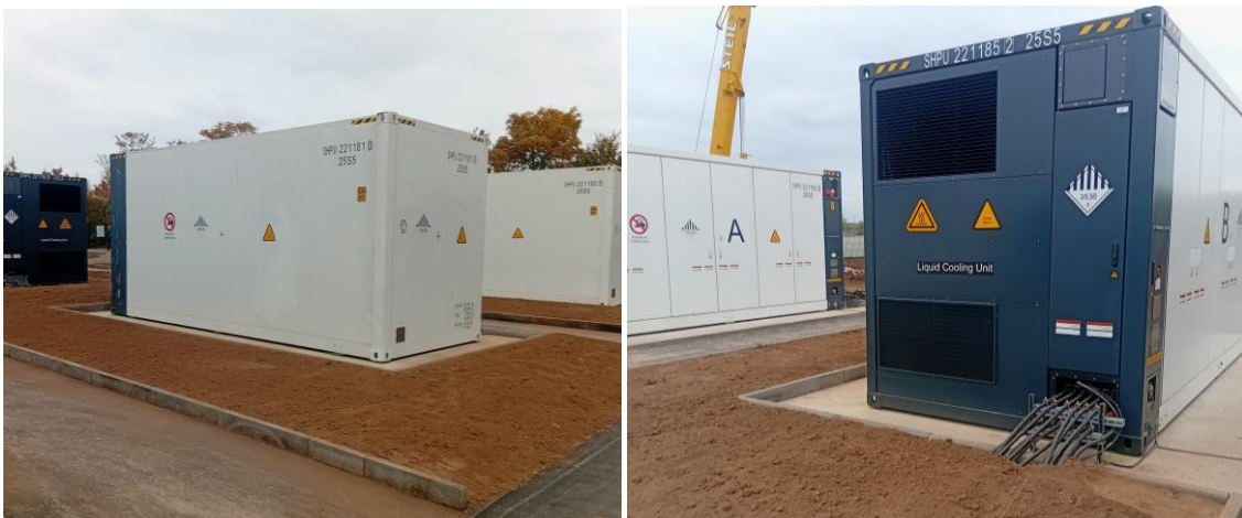
Abb. 6: Beispielhafter Batteriespeicher als Container auf einer befestigten Bodenplatte
